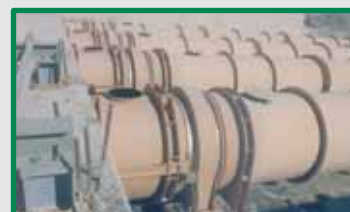
Erfolgreiches Großprojekt mit TITAN Stopfbüchsenpackungen Druckrohrleitungen - Staudamm Attatürk
